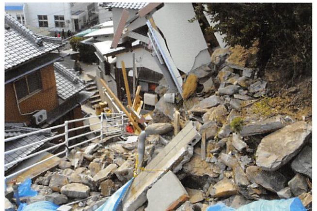
写真-2 家屋・宅地崩壊による道路閉塞
