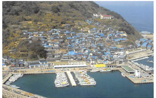
写真-1 玄界島における被災家屋
