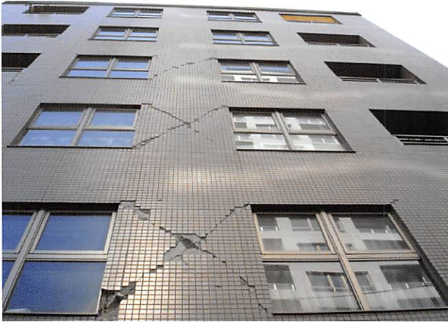
写真-10 新しいマンションの外壁（2次壁）のせん断亀裂
