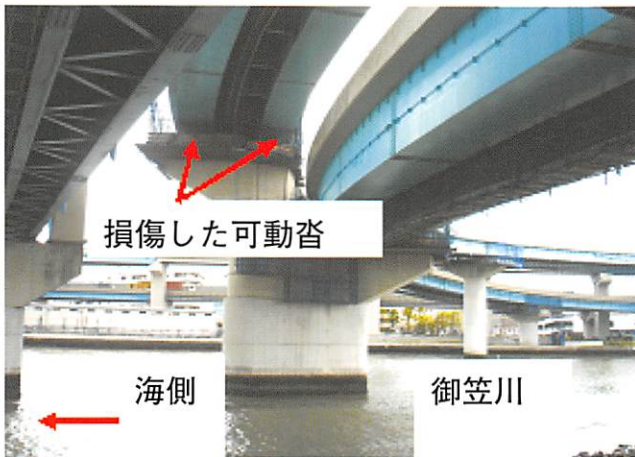
写真-6 支那が破損した曲線箱桁橋
