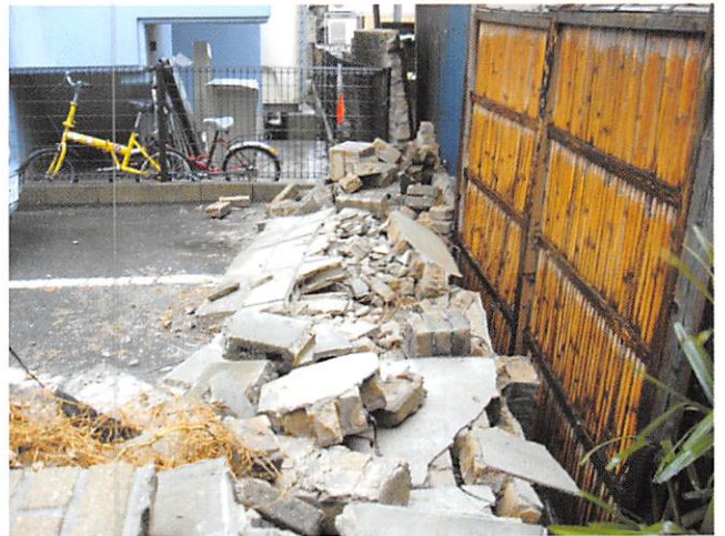
写真-8 ブロック塀の崩壊
